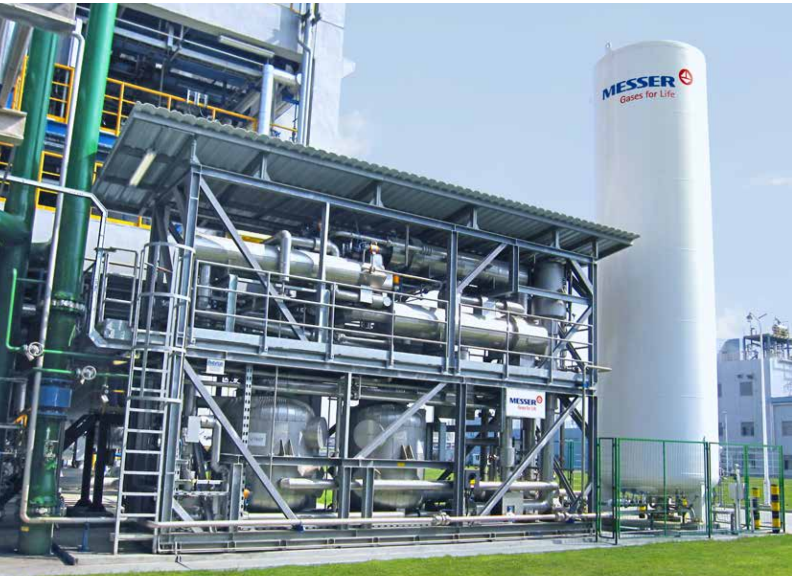
Rückgewinnungsanlage für Methylchlorid
